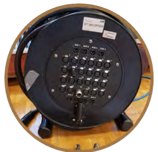
Multicore Kabel mit Trommel (teilweise defekt)
